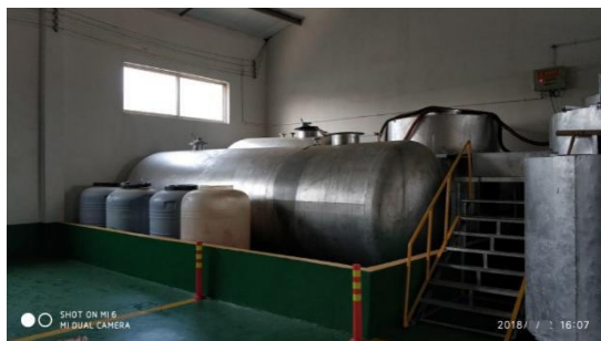
图 2-5 成品暂存区及围堰
